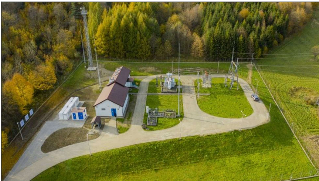
Ryc. 13 Magazyn Energii PGE Dystrybucja Gmina Rzepedź i GPO Źródło: TESLA
