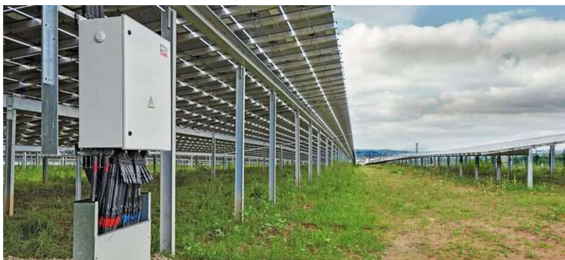
Ryc. 6. Falownik ze string box-em na istniejącej farmie fotowoltaicznej. Źródło danych: The Practical Box Behind the Scenes: SMA String-Monitor and String-Combiner - Sunny. SMA Corporate Blog ( sma-sunny.com )
