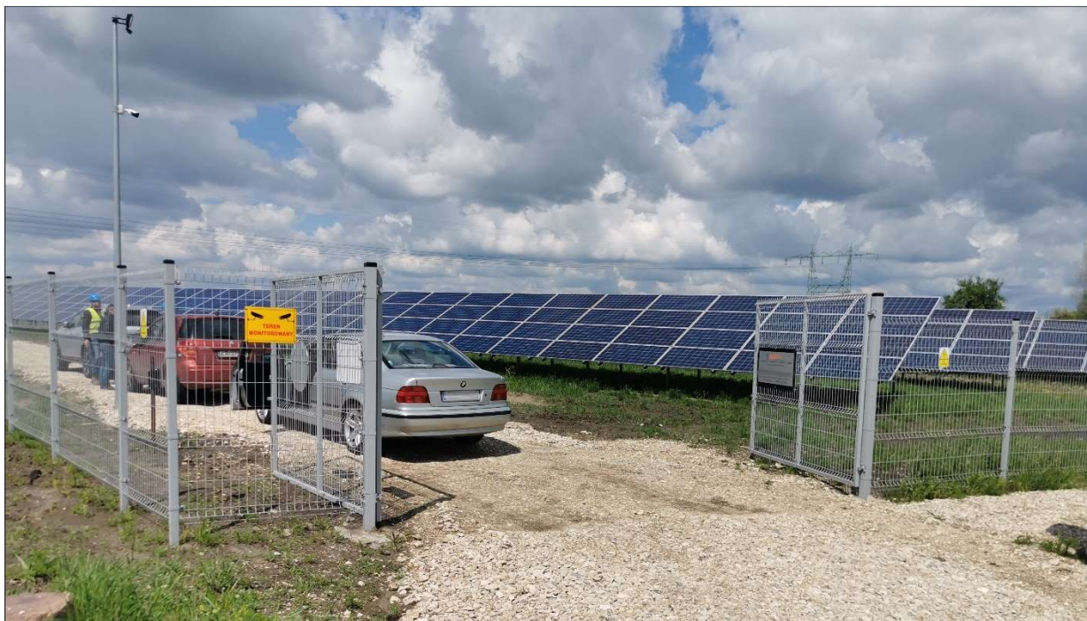
Ryc. 15 Przykładowe ogrodzenie, brama wjazdowa, kamera monitoringu, oświetlenie, droga dojazdowa.
