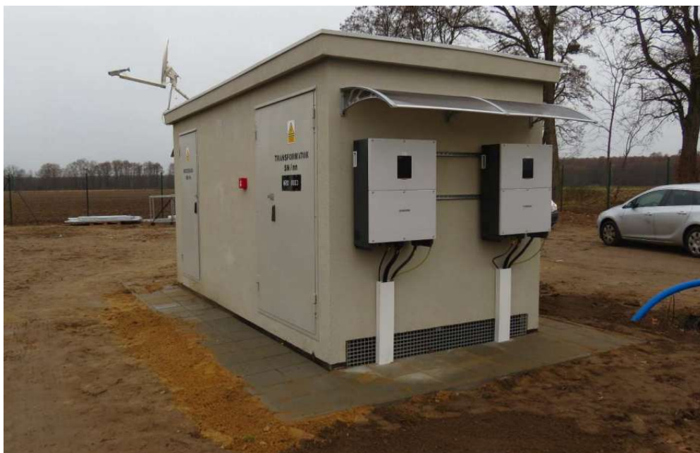
Ryc. 5. Falowniki (inwertery) zainstalowane na stacji transformatorowej SN Źródło: Materiały Inwestora
